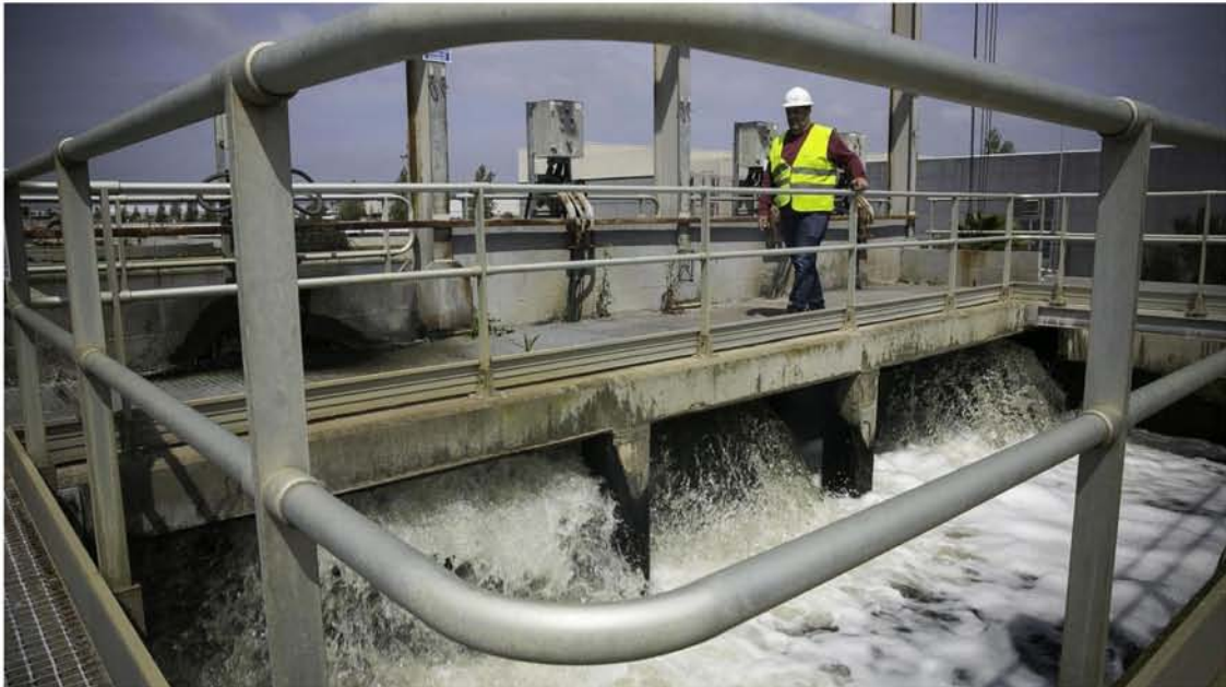
La desalinizadora de El Prat (Baix Llobregat, Barcelona), en pleno funcionamiento. / Joan Cortadellas
